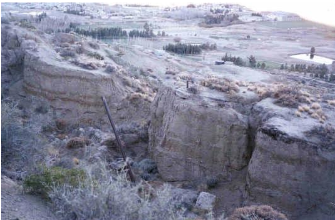
Foto 11: Bajos y grietas en el material movilizado.
